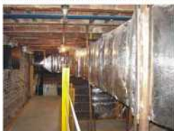
AIRE ACONDICIONADO SALON DORADO-Conductos y Pasarelas Entretecho
